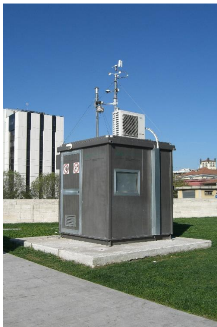
Fig. 16.4: tipica centralina fissa di una rete di monitoraggio
