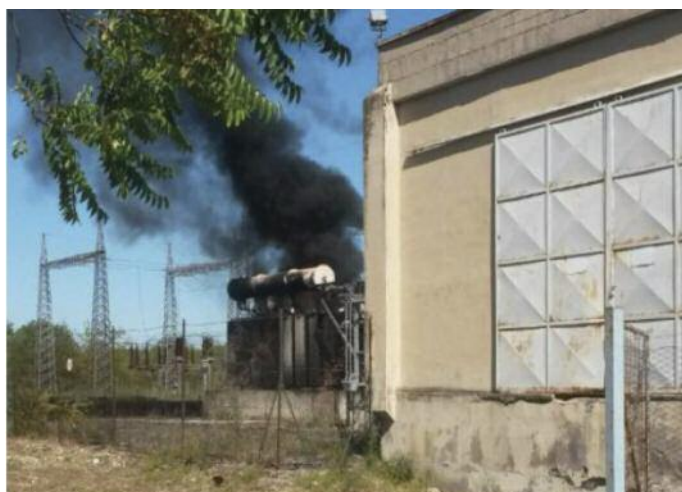
Figura 6: Sottostazione elettrica della "Ori Martin" in fiamme (foto da Ciociaria Editoriale Oggi).
